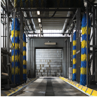
Système de lavage d'autobus automatique
